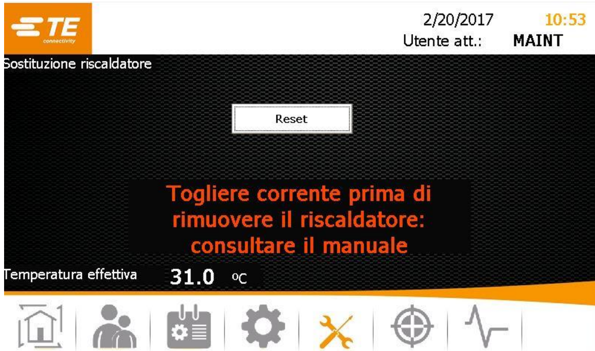
Fig. 29 Schermata Interruzione dell'alimentazione elettrica
