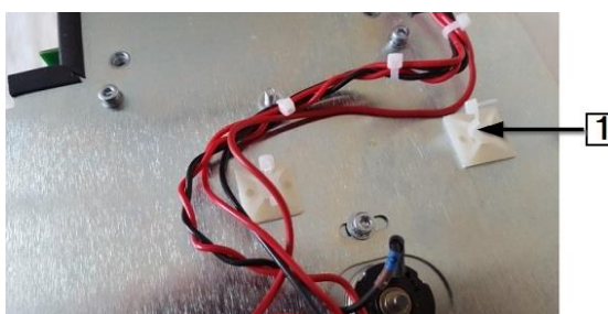
Abb. 49 : Opaski kabli procesora
