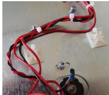
Abb. 73 : Serre-câbles sur le condensateur
