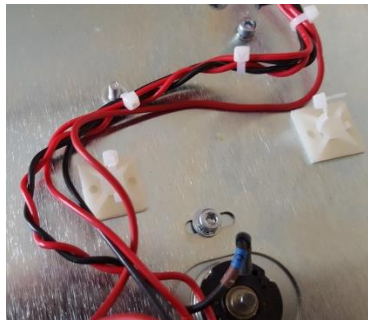
Abb. 73 : Stahovací pásky u kondenzátoru
