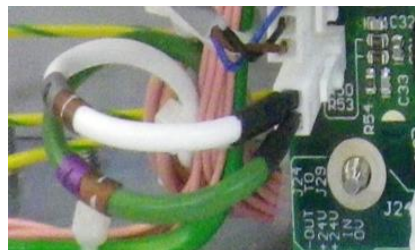
Abb 93 : Thermoelement-Ausgleichskabel an der PCB-Steuerung
