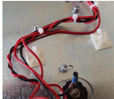
Abb 81 : Kabelbinder am Kondensator
