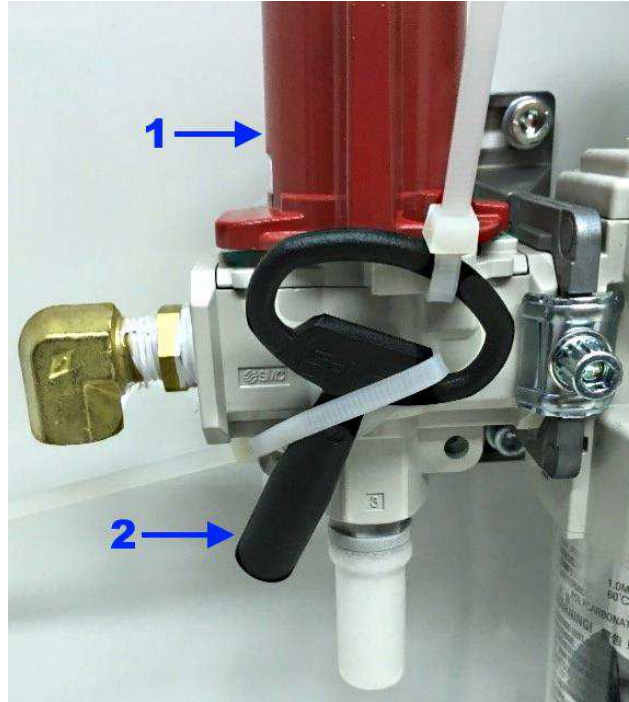
Figura 40: Llave del cuadro eléctrico y válvula de desconexión neumática principal
