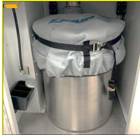
Figura 24: Depósito de desechos
