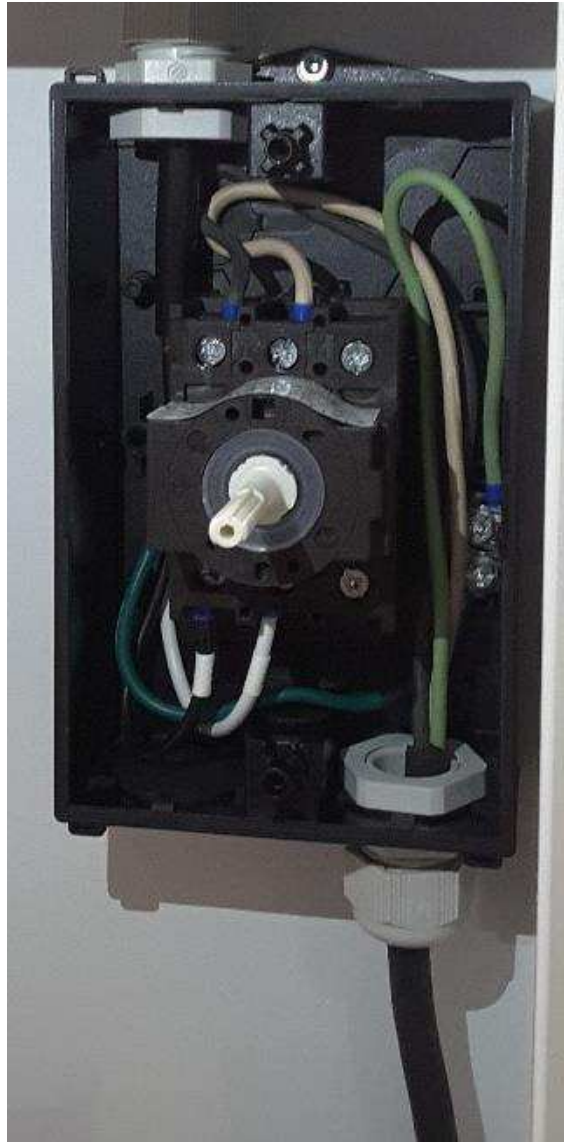
Figura 48: Caja de desconexión con cable de alimentación instalado
