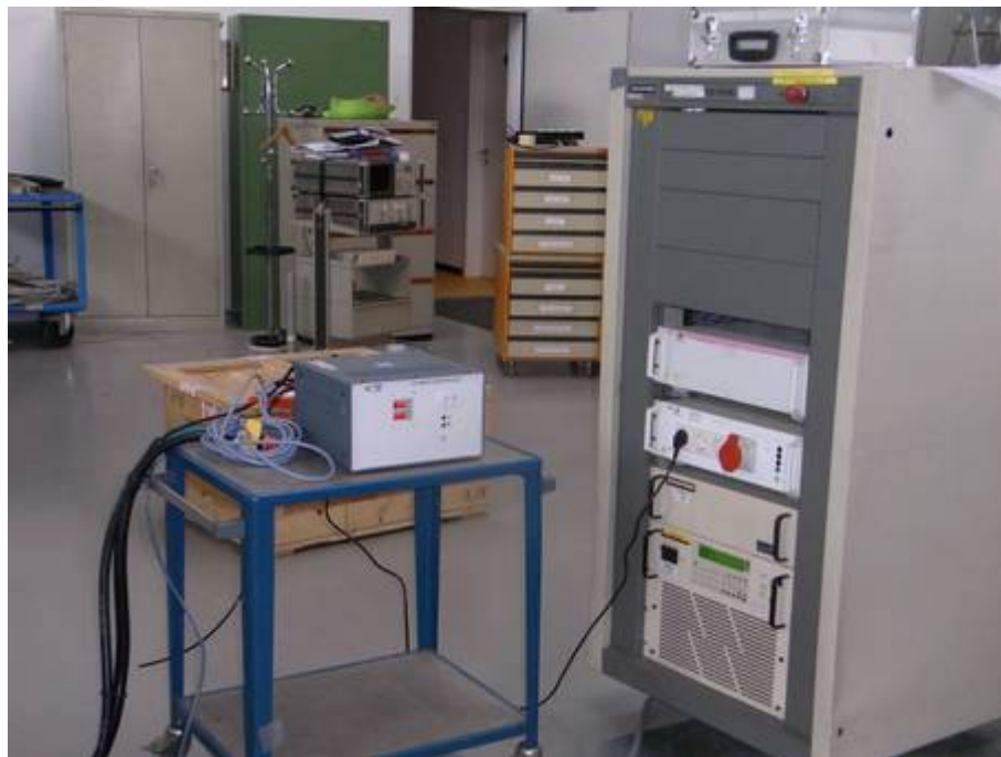
Foto 13: Oberwellenströme, Netzleitung 230V
